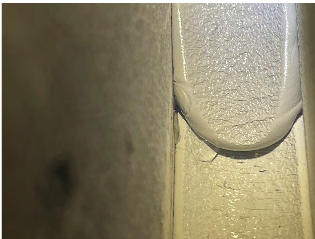
7. Läckage 4 (L4) vid 0-150Pa. Läckage i fogmöte i bakkant av TDV i vertikalskarv.
