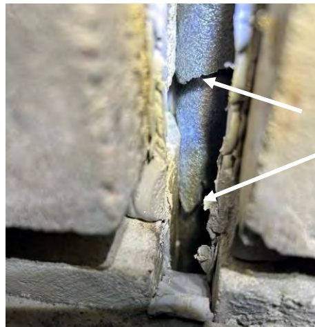
Figur 8. Friläggning av sekundär tätning från baksida fasad, vägg CC. Det ser ut som att bottningslisten består av flera bitar bakom primärtätningen, strax ovanför TDV-öppning, och utgör en trappstegsformation, se pilar.
