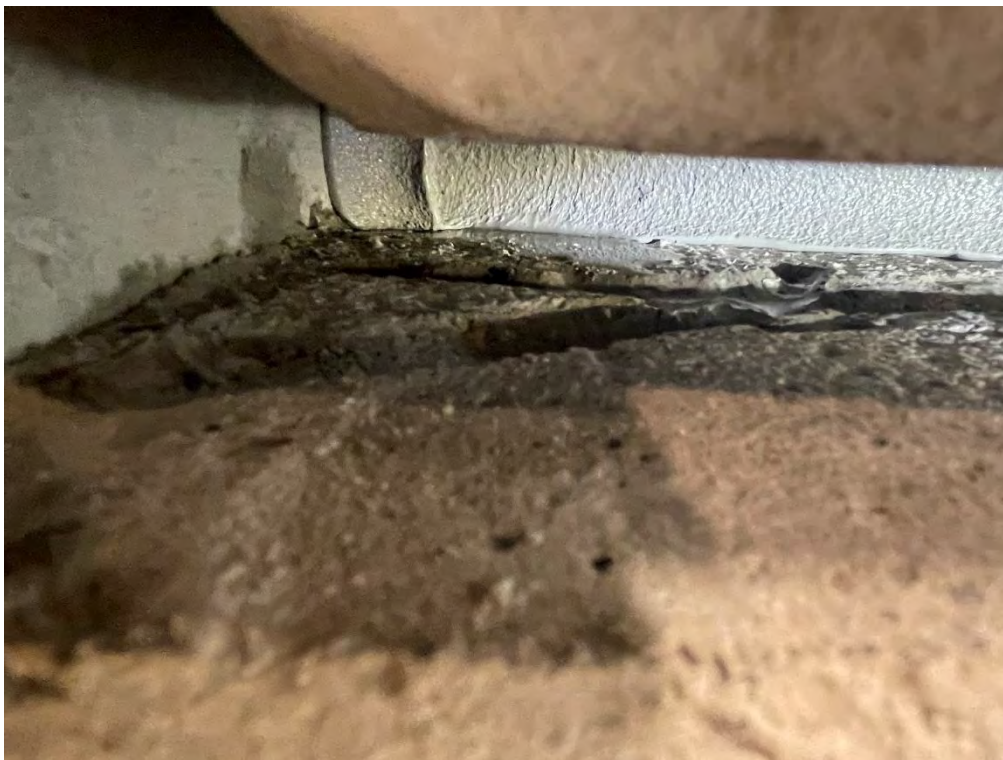
8. Läckage 5 (L5) vid 0-300Pa. Skvätt in via TDV-öppning vid sidan av balkong. Något vatten kom inte in innanför rännen.
