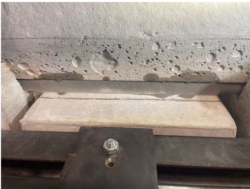
9. Läckage 4 (L4) vid steg 4, 0-300 Pa. Läckage i ovankant fogband ovanför balkong.
