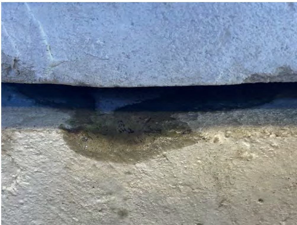
11. Pågående provning (SS-EN 12865:2001) L7. Vatten rinner vid sidan om plåten på båda sidor om balkong. Vid 0-150Pa, Steg 5.
