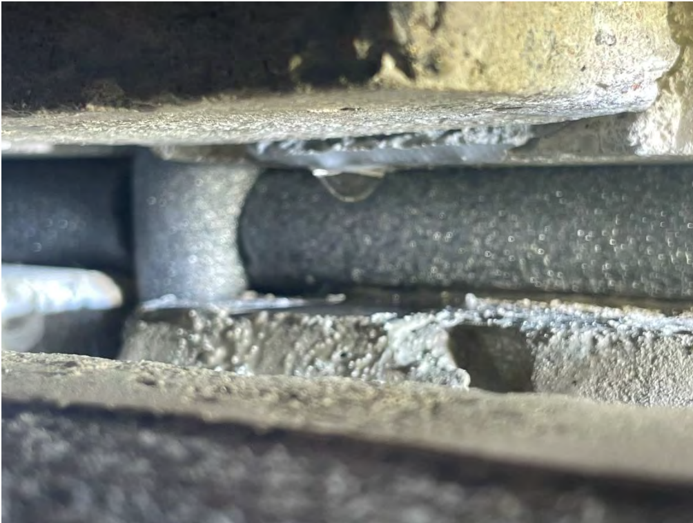
2. Pågående provning (SS-EN 12865:2001) L1. Läckage från genomgående spricka i betongen. (Se bild 3A och 3B). Vid 0Pa, Steg 1.
