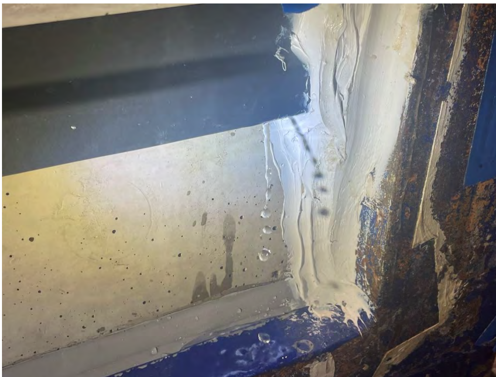
19. Pågående provning (indikationsprovning 2) Dränerat vatten vid sockelplåtens ända.
