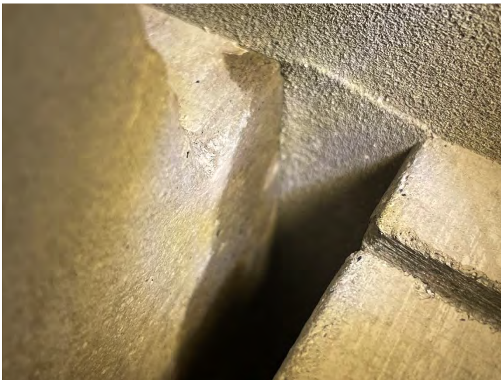
5. Läckage 2 (L2) vid steg 2, 0-75 Pa. Läckage vid fogbandsmöte vid balkong.
