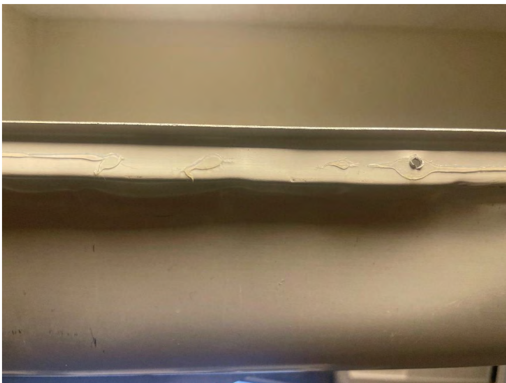
16. Läckagesökning efter provning (SS-EN 12865:2001). Fogsprång på baksida av underbleck.
