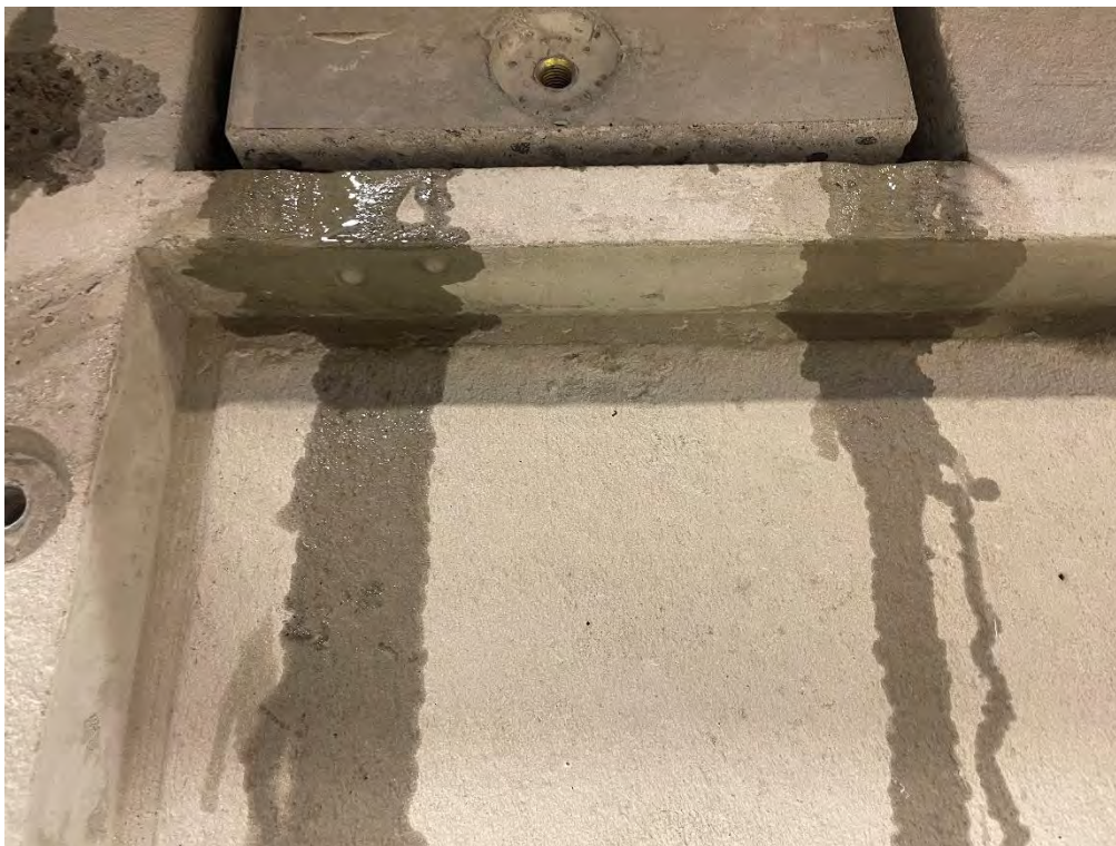
16. Indikativt funktionsprovning 2. Vattnets väg nedanför balkongplattan på baksida fasad.
