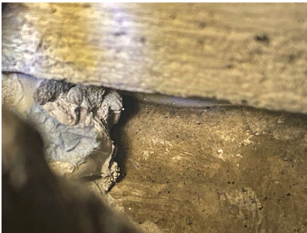
10. Läckage 5 (L5) vid steg 4, 0-300 Pa. Läckage i mötet mellan fog och fogband (väggdel A respektive väggdel D).
