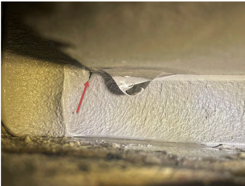
4. Läckage 2 (L2) vid 0-75Pa. Läckage mellan primärfog och balkongenselementets nederhörn. Se röd pil.
