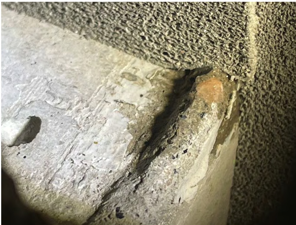
4. Läckage 1 (L1) vid steg 2, 0-75 Pa. Läckage vid fogkryss, fogband.
