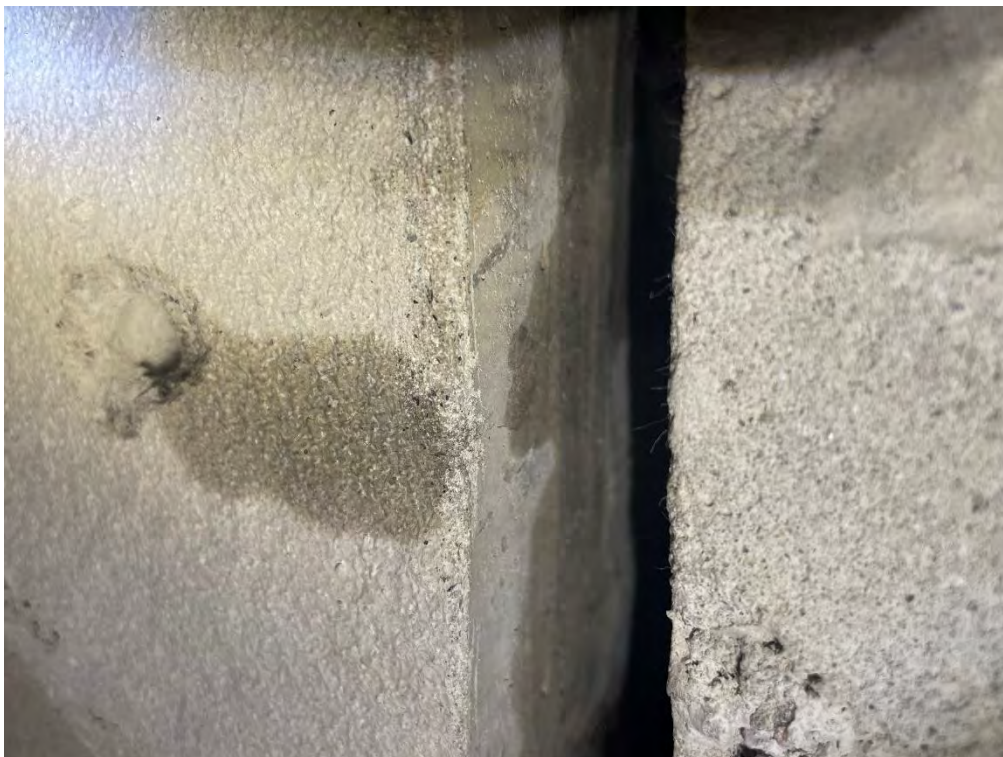
13. Läckage 8 (L8) vid steg 4, 0-300Pa. Läckage i vertikalfog fogband.
