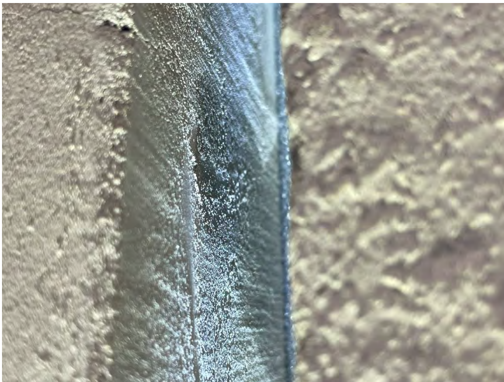
6. Pågående provning (SS-EN 12865:2001) L3. Vertikalfog. Läckage i genomgående spricka i betongen.
