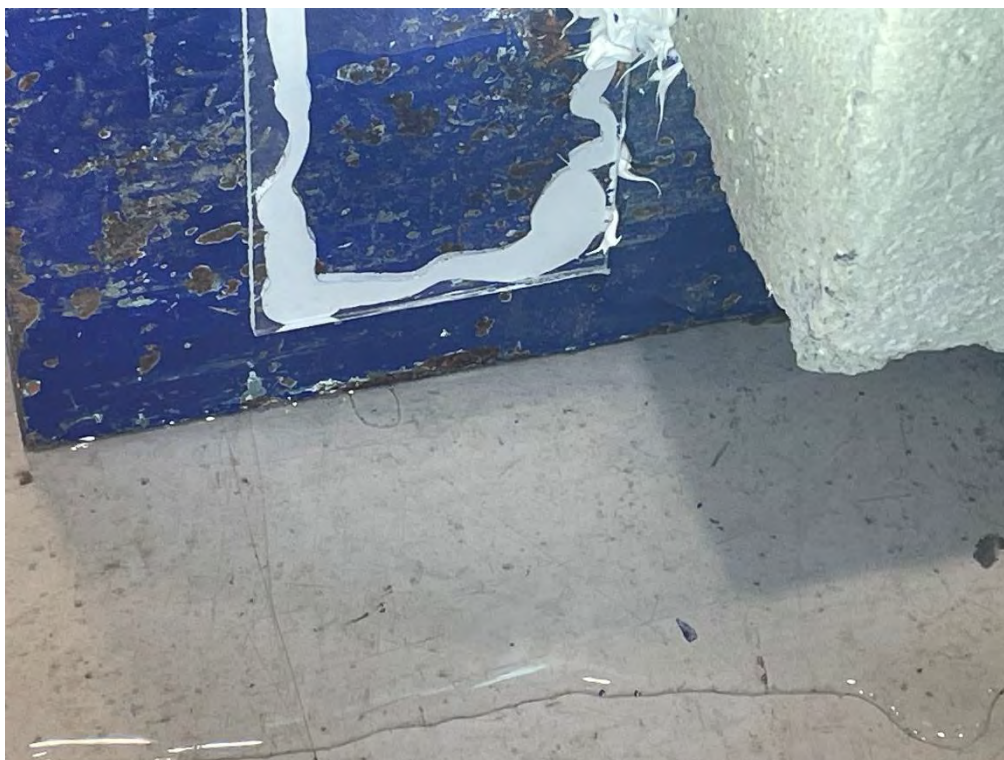
20. Pågående provning (indikationsprovning 2). Inläckage under dränagetest. Vatten rinner bakvägen, tränger fram på insidan. Se även bild 21.
