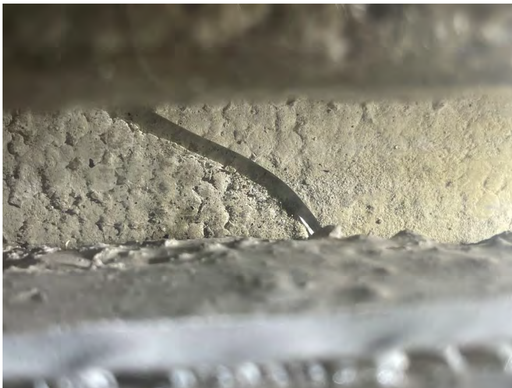
21. Efter avslutad provning (indikationsprovning 2) Stående vatten längs sockelns bakkant som inte kunde dränera ut fullständigt.
