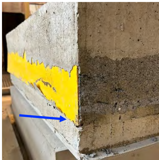
Figur 6. Plastlisten har råkat bli ingjuten i bakkanten av fasadskivan, se pil, varför vattenutledning var förhindrad. Elementet ligger ner på en lastpall.
