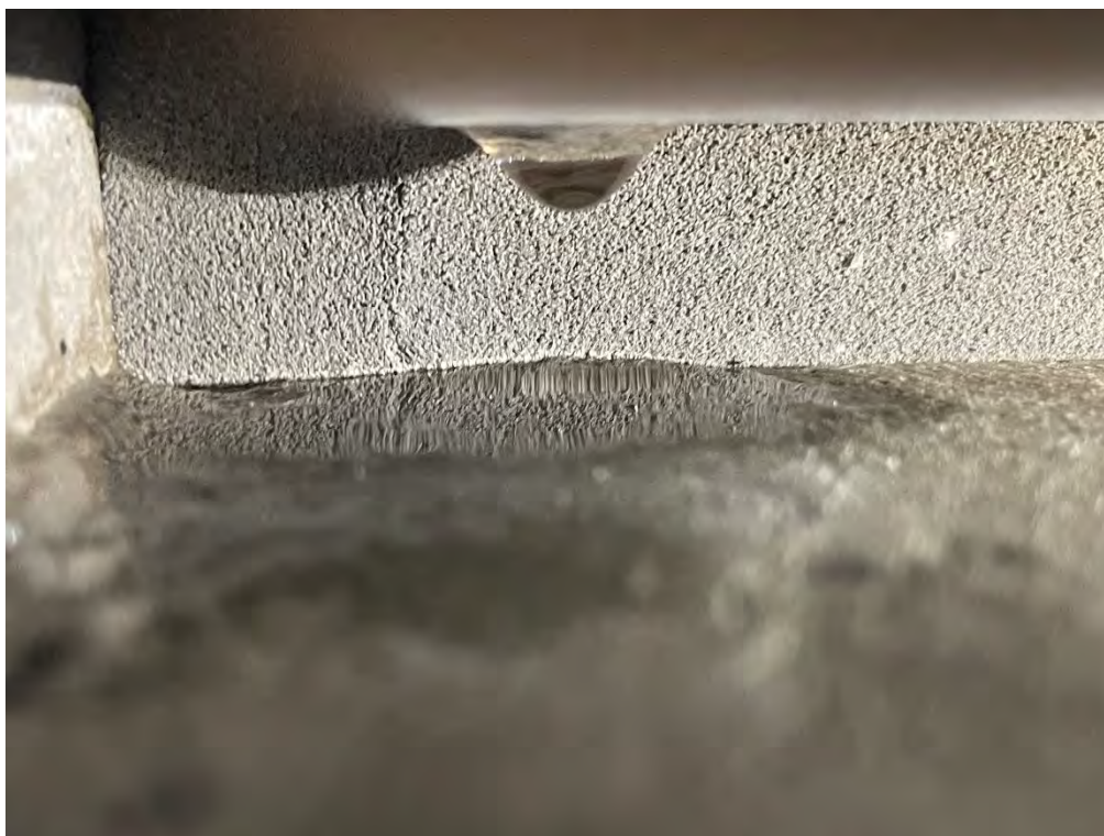
10. Pågående provning (SS-EN 12865:2001) L10. Underkant balkong (vänster). Fogbandsmöte. Vid 0-150Pa, Steg 3.
