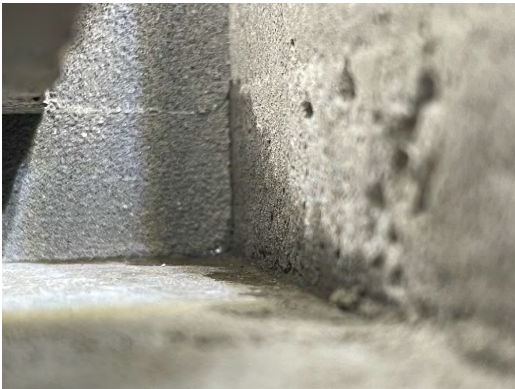
6. Läckage 3 (L3) vid steg 2, 0-75 Pa. Läckage i hörnet vid fogband på undersida balkong.
