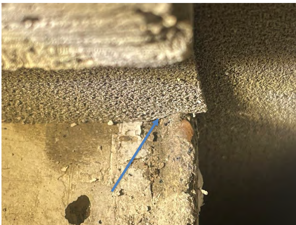
3. Pågående provning (SS-EN 12865:2001) L3. Vid vertikalfog- fogkryss underkant fogband vid 0Pa, Steg 1. Se blå pil.
