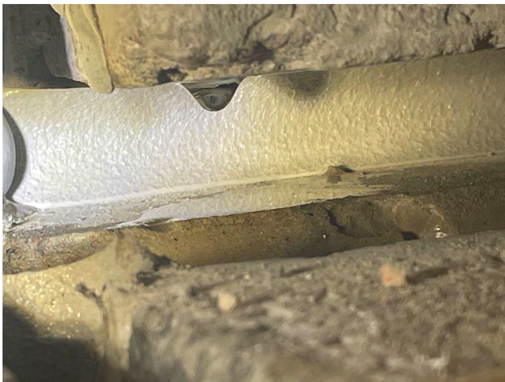
2. Notering 1 (N1) vid 0Pa. Dropp från spricka med lagning i betongen.
