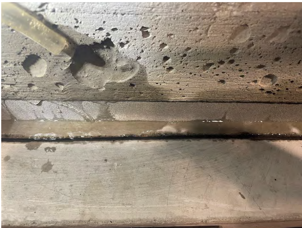
17. Indikativt funktionsprovning 2. Påfört flöde på baksida fasad. Se utfallet i bild 15-16
