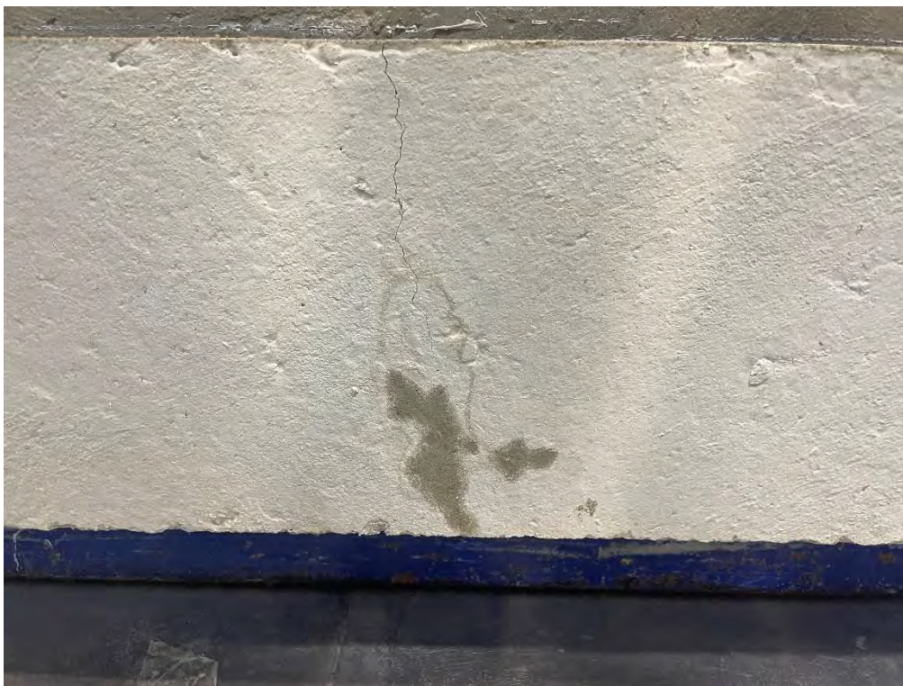
5. Läckage 3 (L3) vid 0-150Pa. Läckage genom spricka i betongsockeln.
