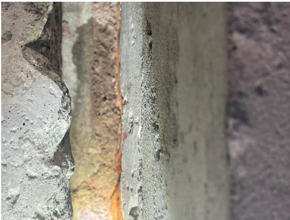
13. Pågående provning (SS-EN 12865:2001) L13. Vattengenomslag i isoleringsskiktet runt fönsterhålet. Vid 0-150Pa, Steg 3.
