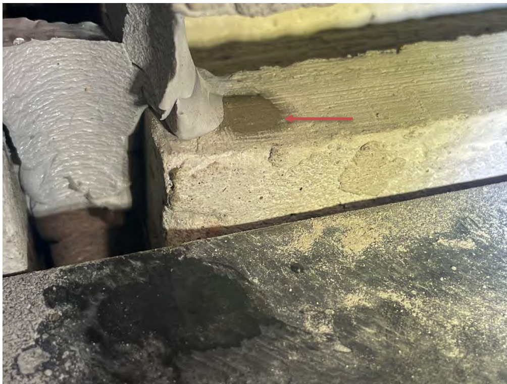
3. Läckage 1 (L1) vid 0-75Pa. Skvätt från TDV-öppning innanför rännan. Se röd pil.
