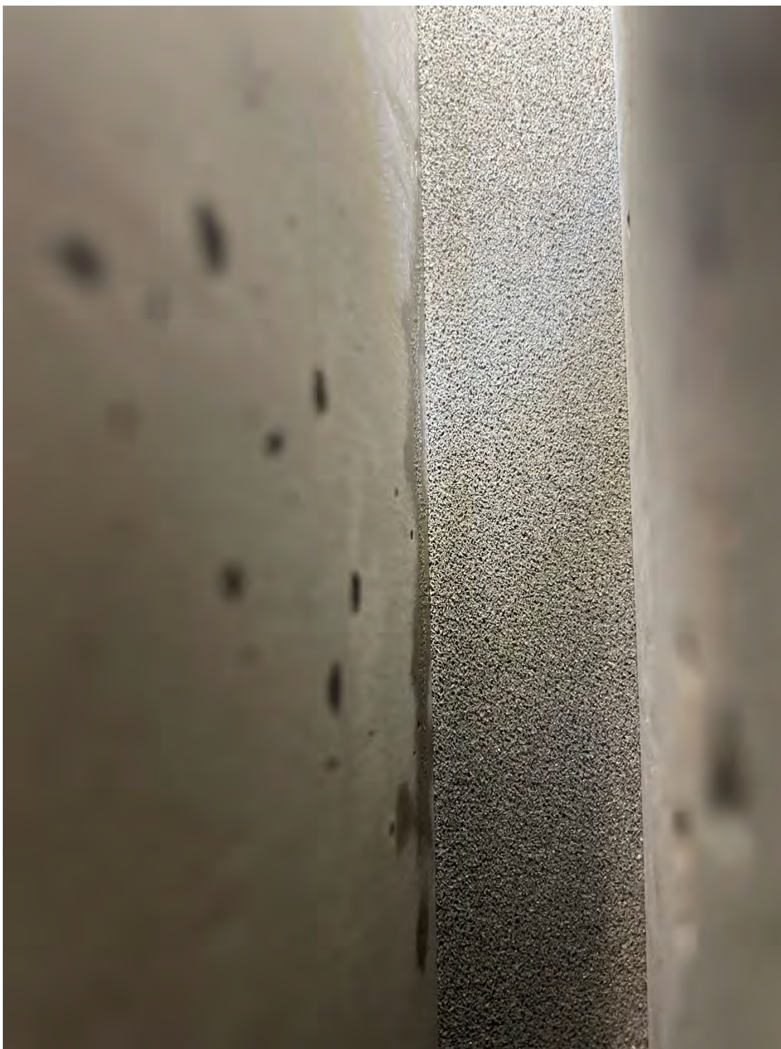
12. Läckage 7 (L7) vid steg 4, 0-300Pa. Läckage i vertikalfog fogband.
