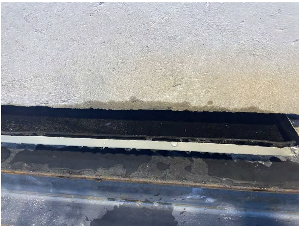
13. Pågående provning (SS-EN 12865:2001) L8. Vatten spiller över plåt med uppvik i bakkant, ovansida balkong. Vid 0-300Pa. Steg 6.
